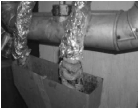
Azbeszt szigetelés csöveken
